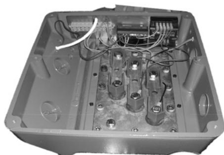
Электрическая коробка и клеммная панель
